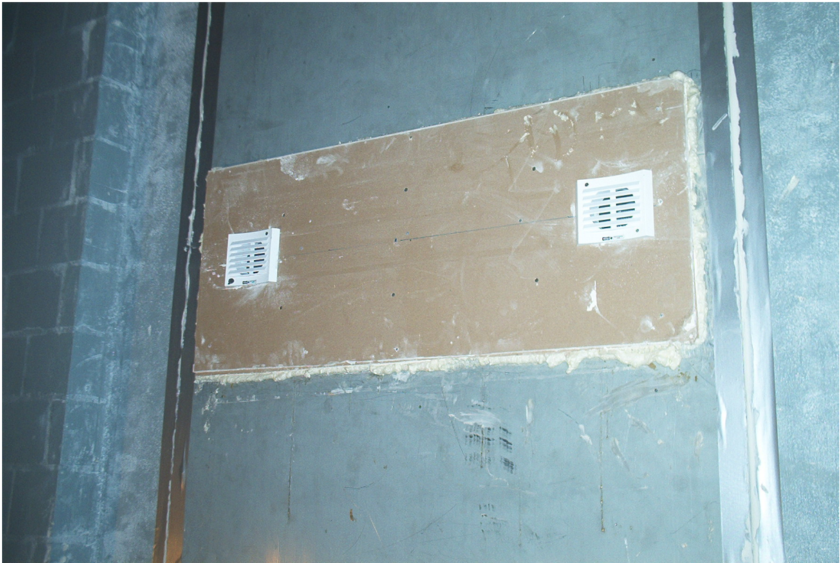
Figuur 2: Ventilatie toe- en afvoer uitmondungen in meetopening ('buitenzijde')
