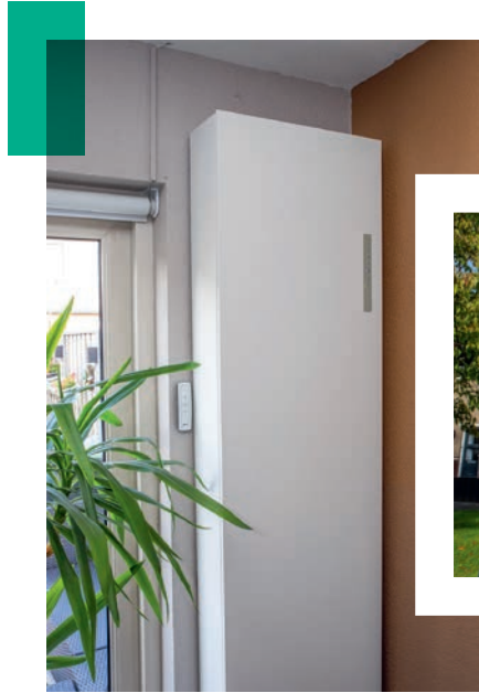
WTW-UNIT IN DE WOONKAMER
